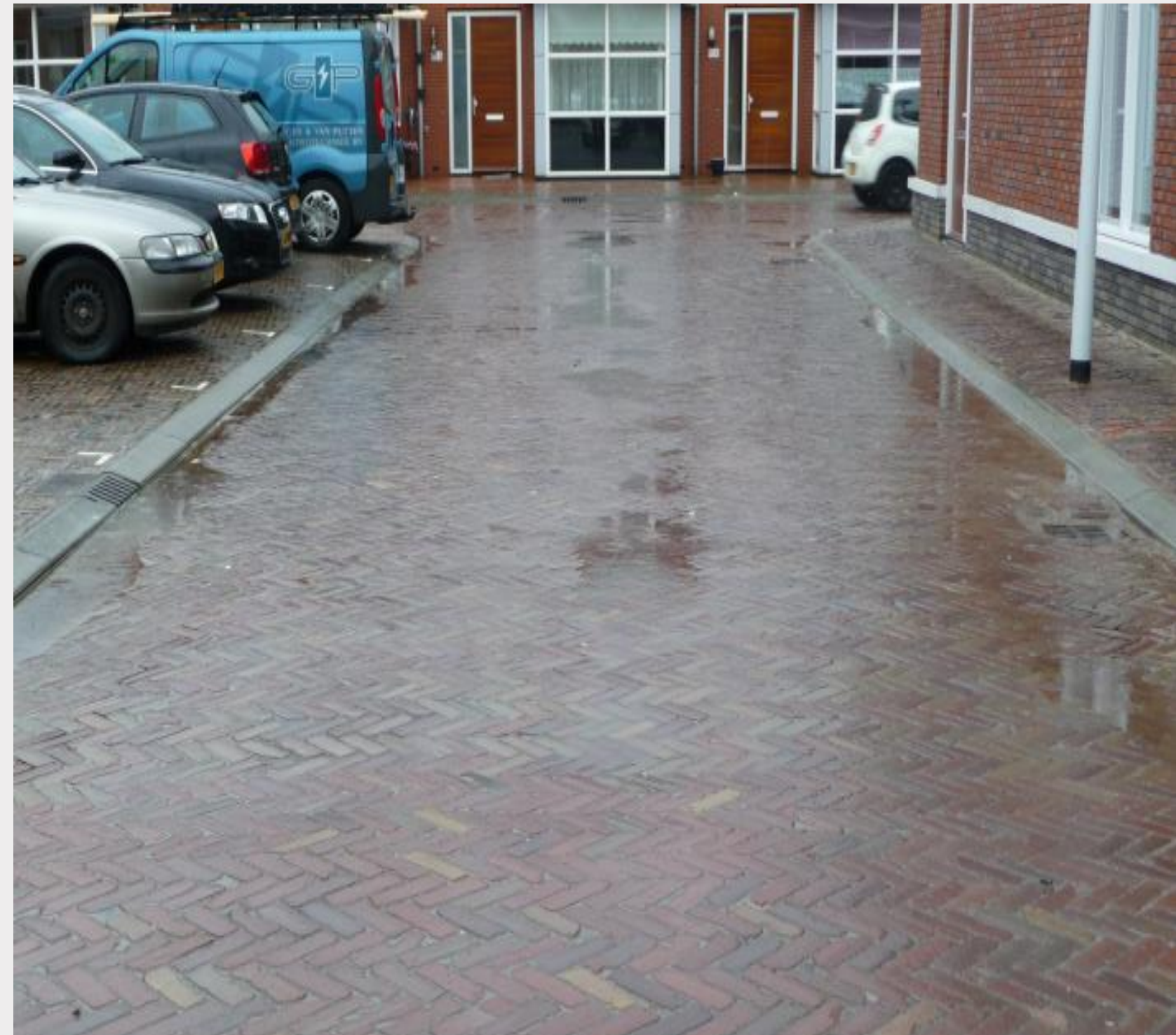
Spoorvorming in kruin + zijkanten
