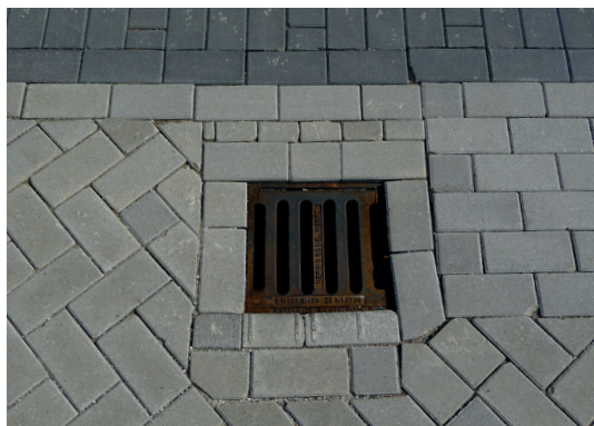
Afb. 15 Kolken: de vorm van de kolken varieert. In deze beide gevallen is te weinig aandacht besteed aan de kwaliteit van het paswerk rondom de kolken
