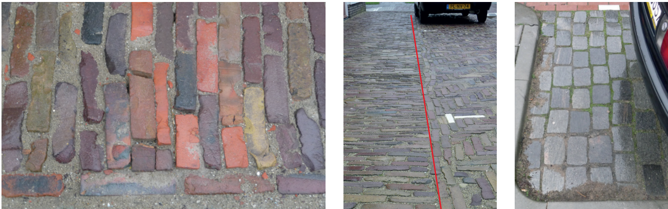
Afb. 12 Plaatsing: voorbeeld van slechte plaatsing van straatstenen. Ook de sortering op vorm, kleur en het paswerk is niet in orde (links). Verband en rechtheid van lagen: een tweetal gevallen van slecht halfsteens verband en van onvoldoende rechte lagen (rechts).
