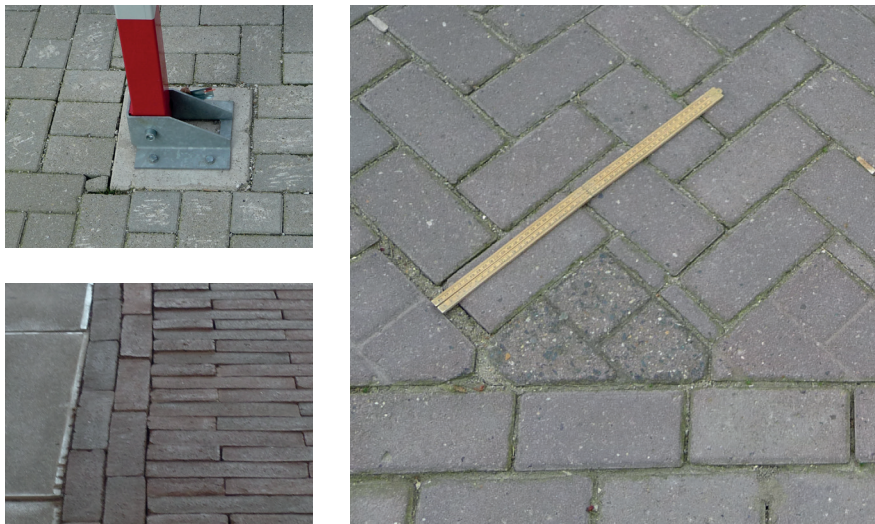
Afb. 10 Paswerk: een drietal gevallen van slordig uitgevoerd paswerk zoals: te kleine passtukken; beschadigingen door de straathammer; bisschopsmutsen met textuur verschillen en op de kop geplaatste stenen.
